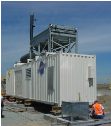
1.2 MW Genset Module
